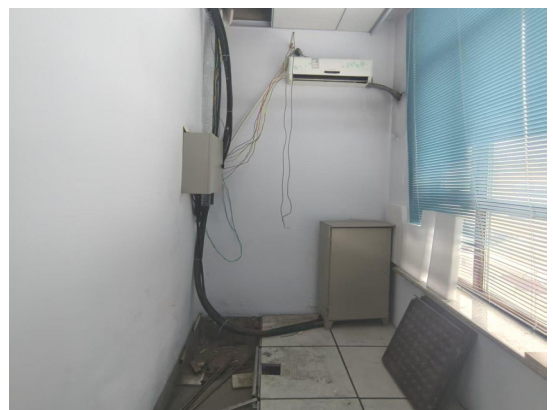
DSA 手术室北侧设备间
