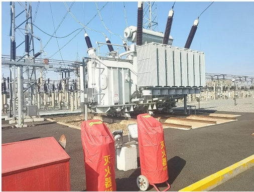
变电站现有 1#主变位置
