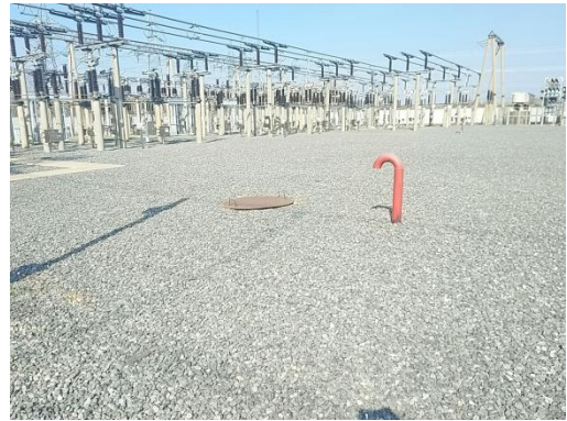
变电站现有事故油池、拟建事故油池及 2#主变位置
