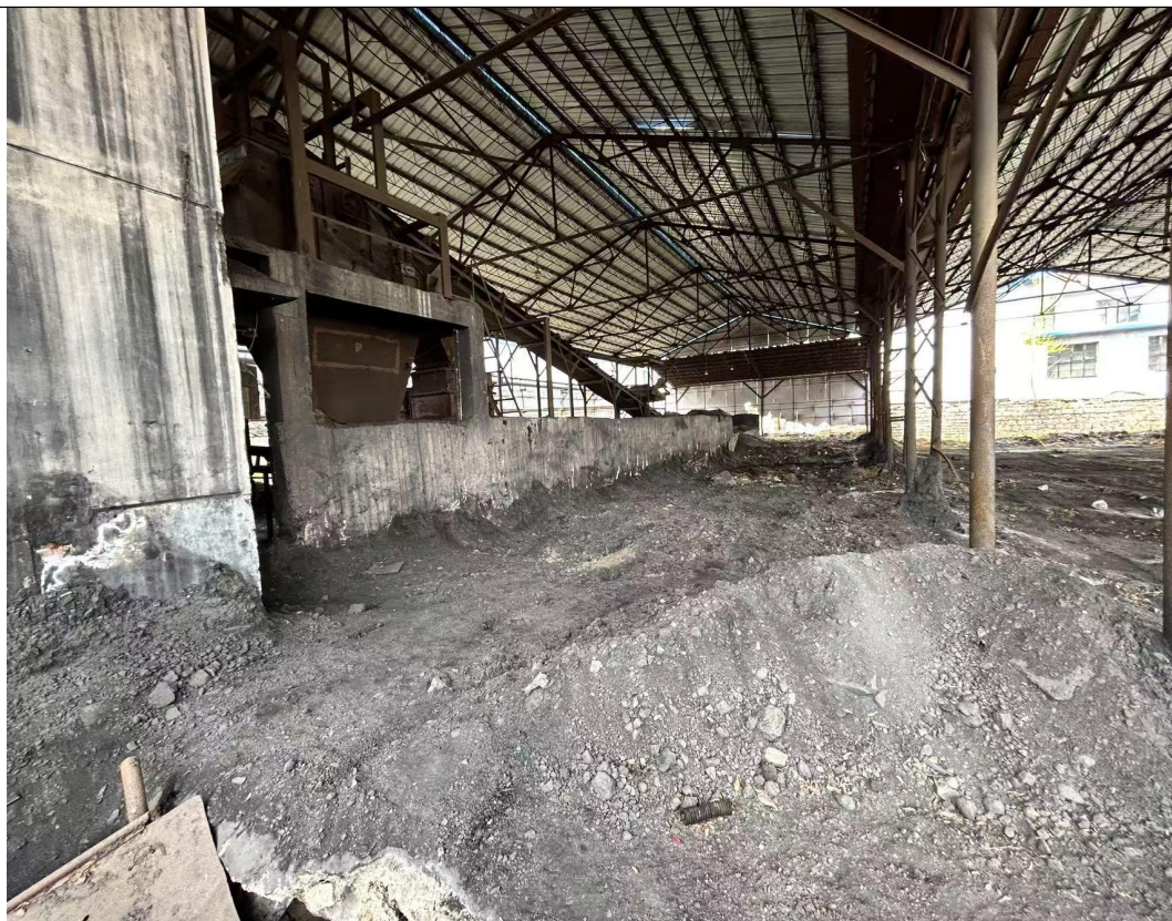
煤棚地面存在残留煤灰、煤渣
