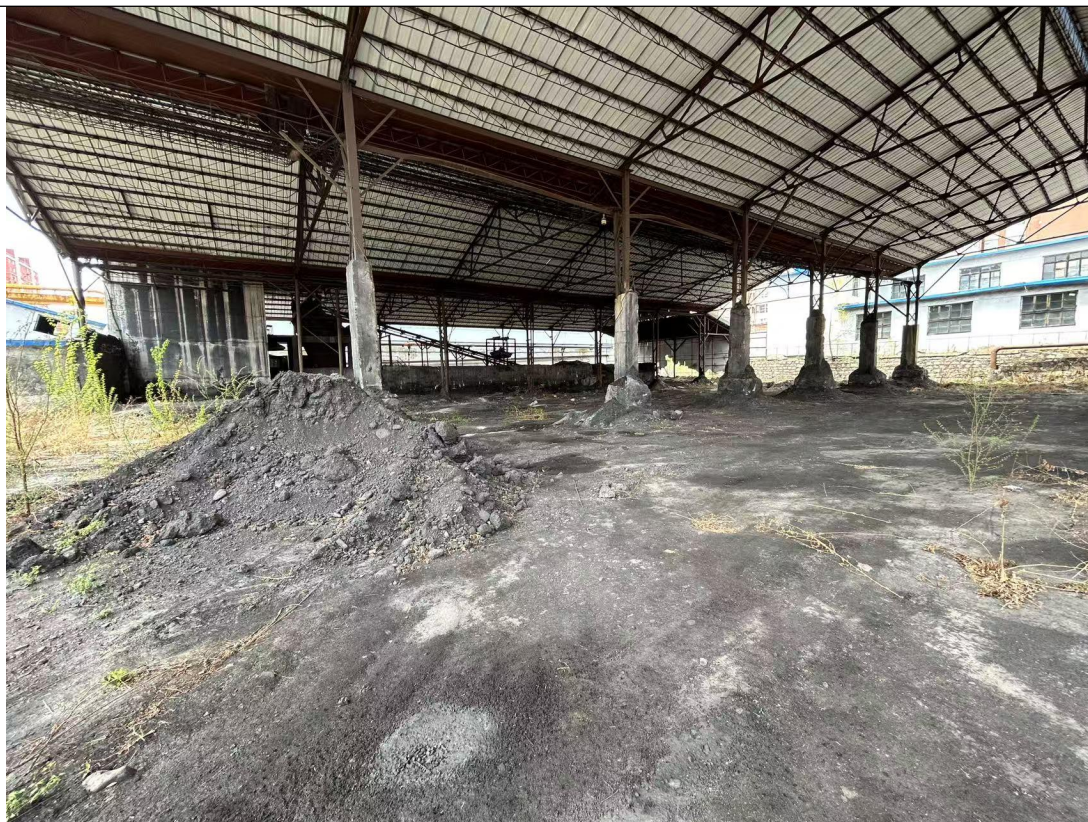
地块内未拆除的煤棚，煤棚地面存在残留煤灰、煤渣
