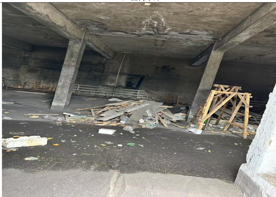
厂区内库房，现存在少量建筑垃圾
